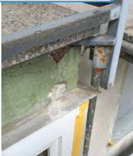
Die Balkonplatten waren undicht geworden. So konnte Feuchtigkeit in die Bausubstanz eindringen.
