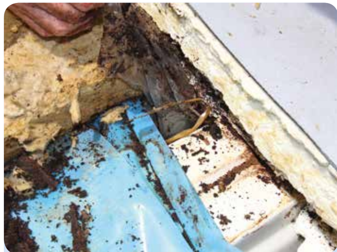
Fehlende Dampfbremsenabschlüsse lassen über Luftströmung (Konvektion) eine 100 bis zu 1000-fache Menge an Feuchtigkeit eintreten – im Vergleich zur Diffusion bei einer intakten Dampfbremse.
